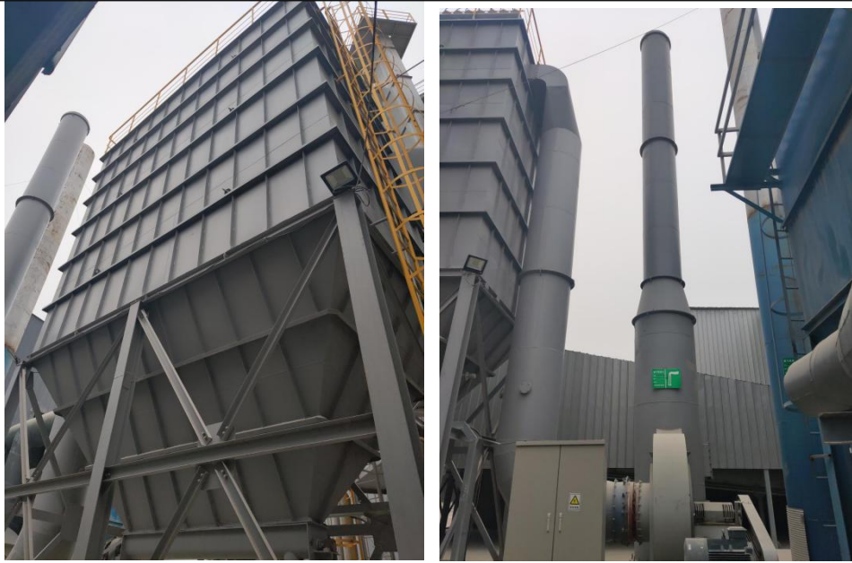
图 8 成品处除尘器及排气筒
