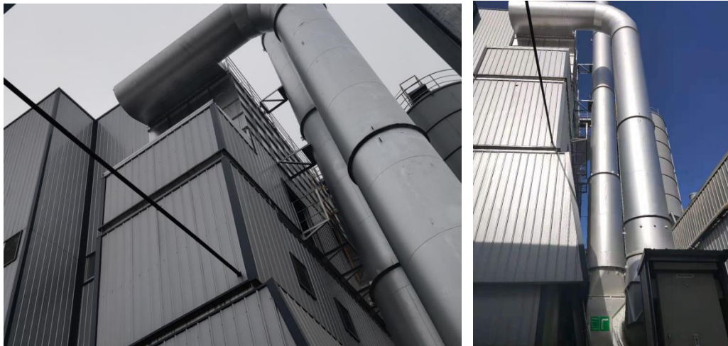
图 7 热再生处除尘器及排气筒
