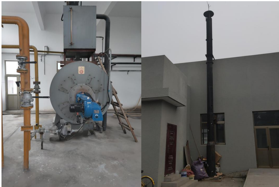
图5 供暖燃气锅炉及排气筒
