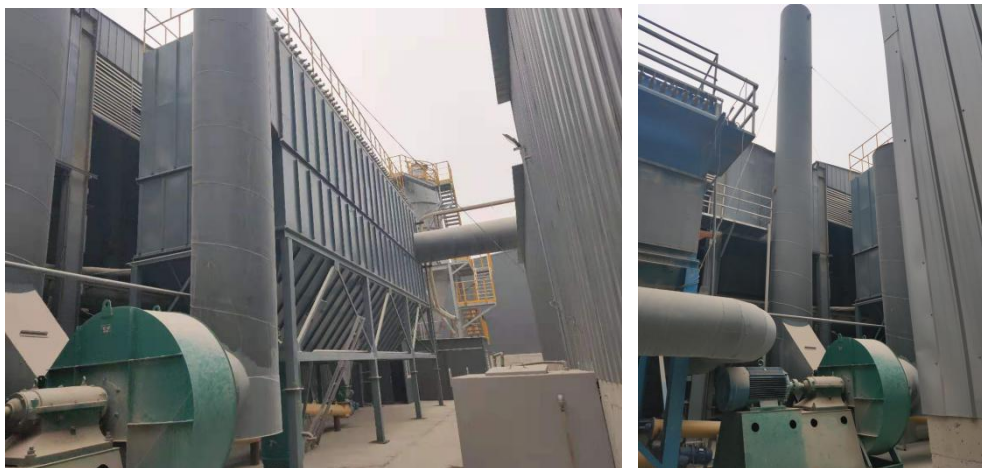
图 9 沥青存储罐区废气净化设施及排气筒
