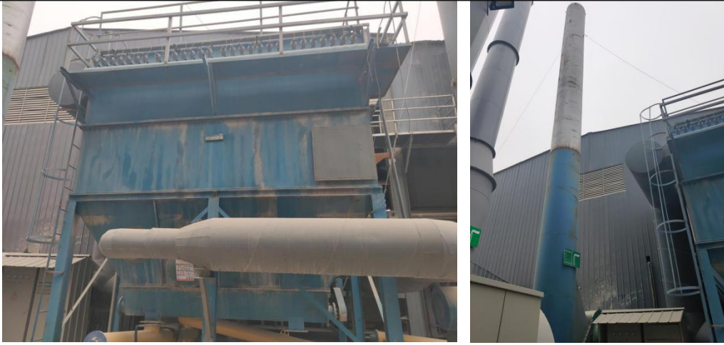
图 6 上料处除尘器及排气筒
