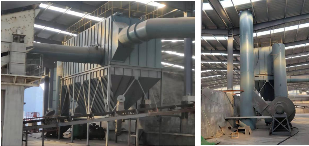
图 10 冷再生生产线除尘器及排气筒
